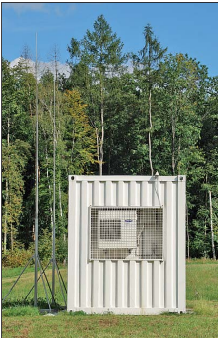
Bild 5: Klimatisierter Container für die Empfänger und die Datenübertragung; die Vertikalstäbe an der linken Seite sind Blitzableiter.
